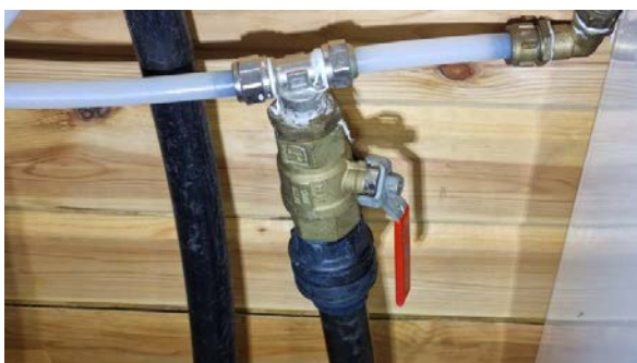
Kontroll av innvendig hovedstoppekran.
