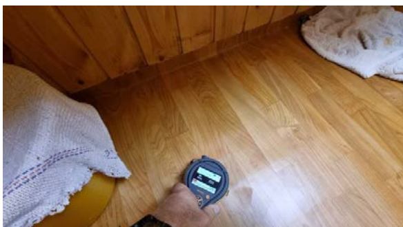
Fuktmåling i boden, noe forhøyede fuktverdier ble registrert.
