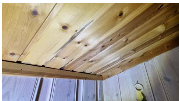
Fuktmerker i himling over kjøleskapet.
