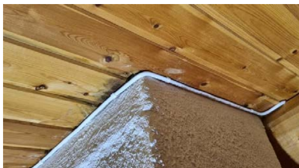
Fuktmerker ved pipen.
