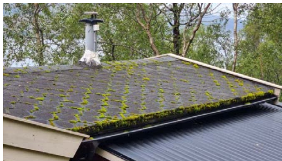
Mose i taktekket.
