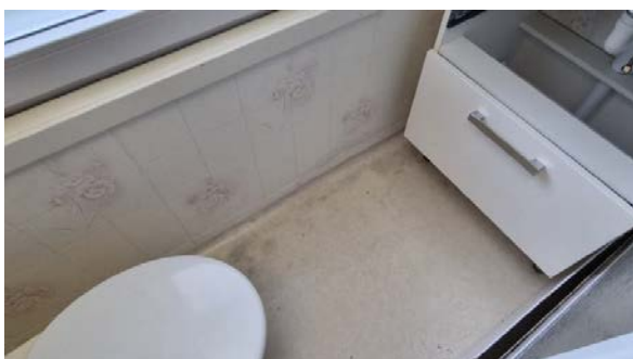
Misfarging i belegget.
