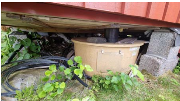
Tank under klosettet.
