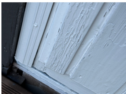
Synlig slitasje på balkongdør.
