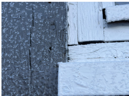
Synlige slitasjer på utvendig karm
