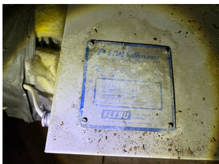
Eldre aggregat plassert på kaldloft.
