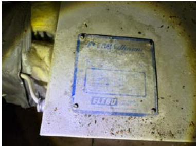
Eldre aggregat plassert på kaldloft.
