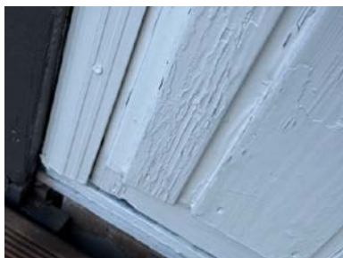
Synlig slitasje på balkongdør.
