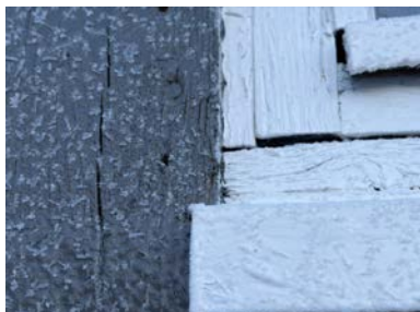
Synlige slitasjer på utvendig karm
