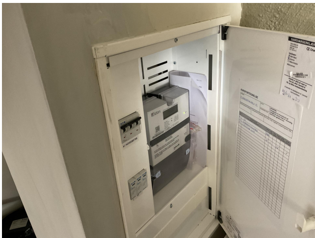
Sikringskap på loft.
