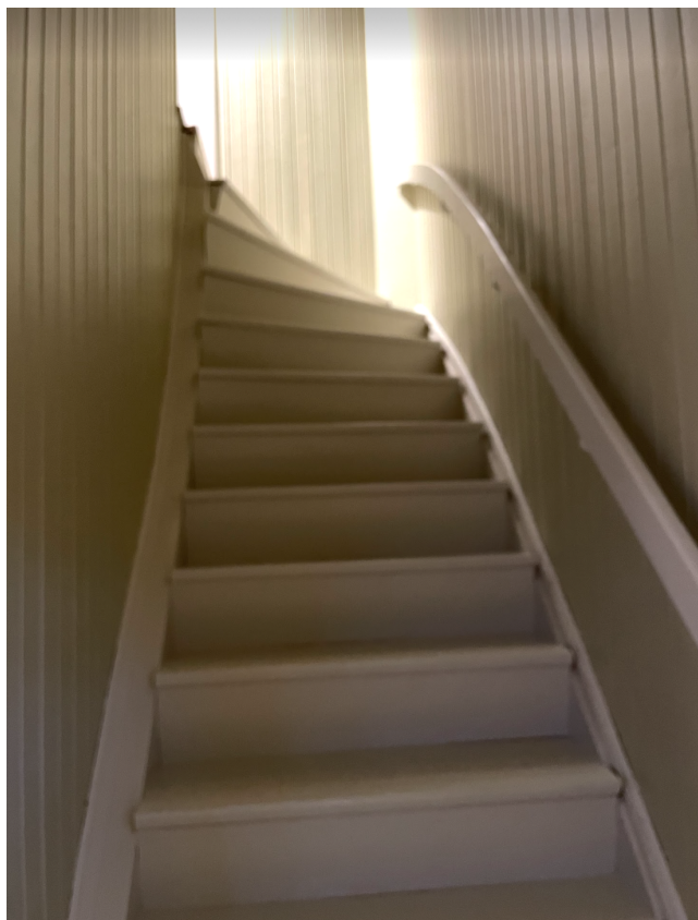
Trapp fra 1. etg. og til 2. etg. Manglende håndløper på vegg.
