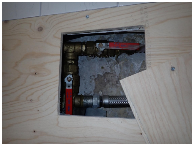
Stoppekran bak luke i vegg i bad.
