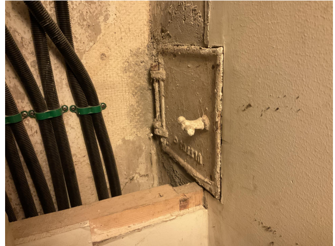
Feieluke i bod i kjeller med kort avstand til brennbart materiale..
