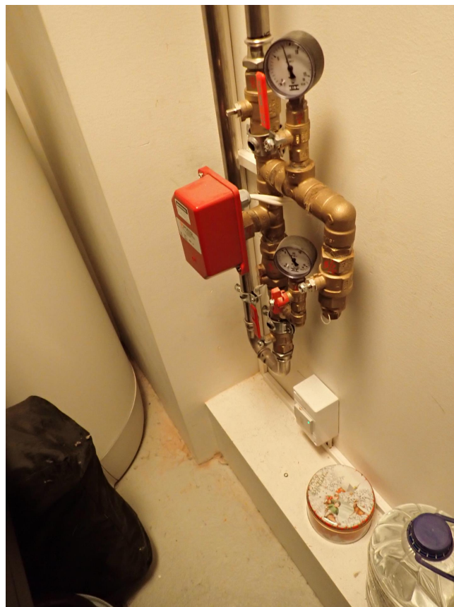
Sentral for sprinkler-system i bod i kjeller.
