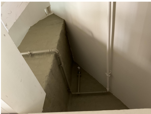
Sprinklet slokkesystem i hele boligen.
