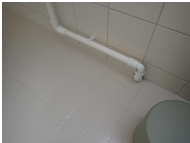
Usikker membran-løsning ved rør-gjennomføring.
