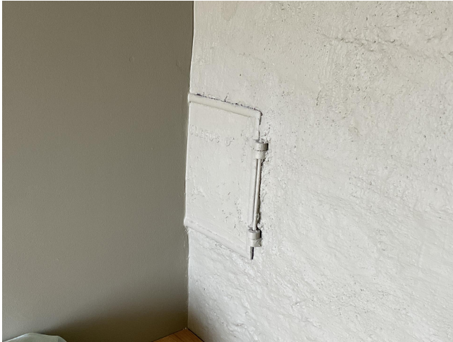
Feieluke på loft låst av veggkonstruksjon.
