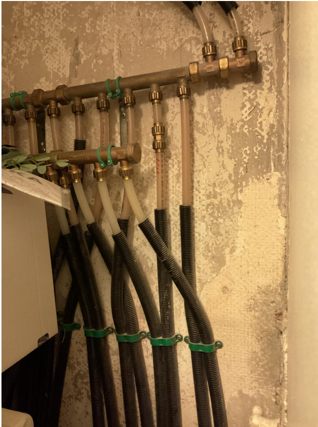
Samlestokk for rør-opplegg i bod i kjeller. Plassert i rom uten sluk.
