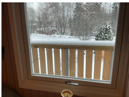
Soveromsvindu tar i karm ved åpning/lukking.
