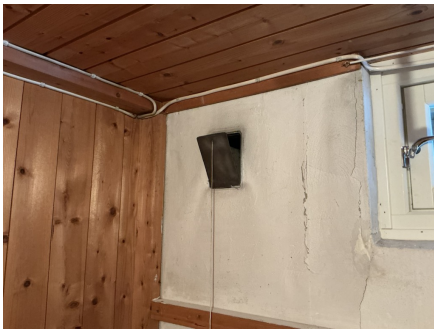
Klappventil for naturlig ventilasjon av rommet.
