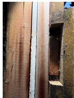
Det er ikke etablert lufting bak kledningen.
