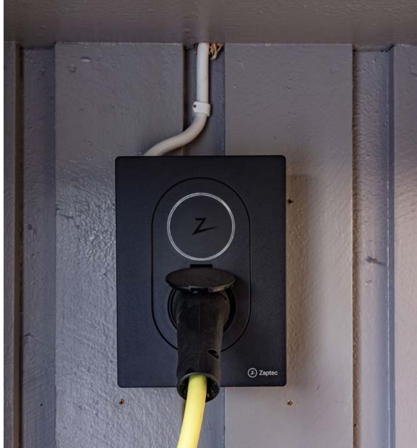
Montert elbil-lader utenfor inngangsdør i 2025.
