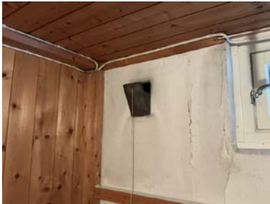
Klappventil for naturlig ventilasjon av rommet.
