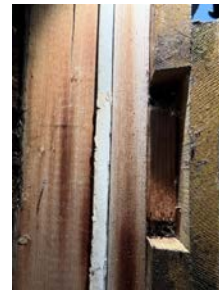
Det er ikke etablert lufting bak kledningen.
