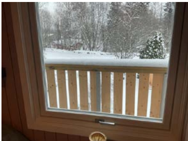
Soveromsvindu tar i karm ved åpning/lukking.
