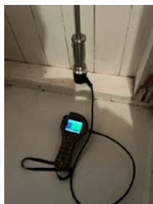
Fuktmåling i bunnsvill i delevegg.
