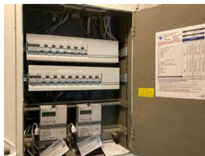
Sikringsskap i felles trappegang
