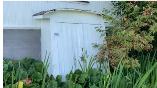
Eldre kjellerdør var ikke i bruk på befaringsdagen - tiltak må påregnes.
