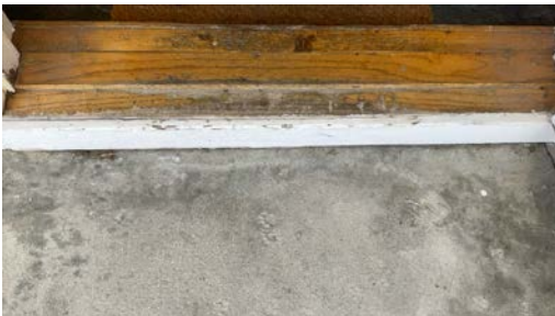
Beslag under ytterdør anbefales montert
