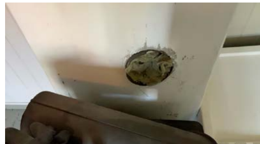
Hull etter sotrør bør tettes eller varmekilde bør tilkobles.
