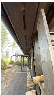
Det er ikke montert flueduk i raftekasser
