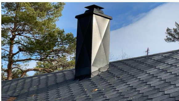
Ikke montert takstige opp til pipe
