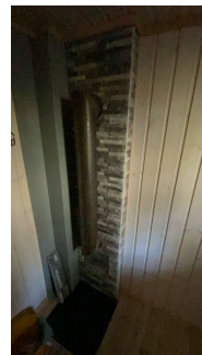
Sotluke og rør inne på vaskerom som benyttes til oppvarming av rom
