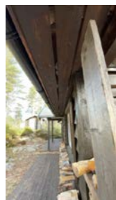
Det er ikke montert flueduk i raftekasser
