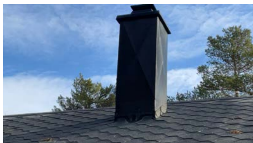
Pappshingel er limt inn på pipebeslag. Ikke fagmessig utført.
