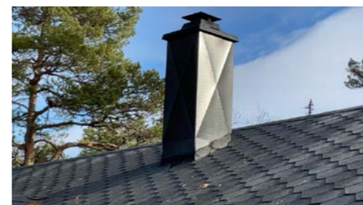
Ikke montert takstige opp til pipe
