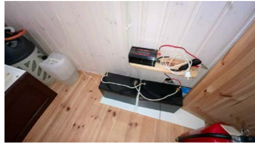
Batteripakke er plassert på bod/teknisk rom
