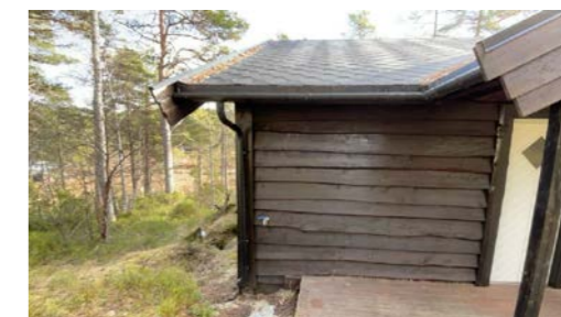
Takvann er ført til terreng
