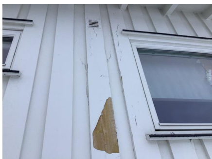
Eksempel på løsnet maling.
