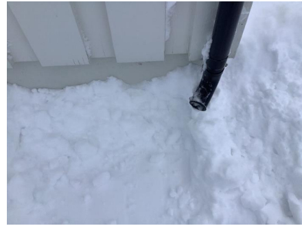
Eksempel på mangelfull bortledning av takvann.
