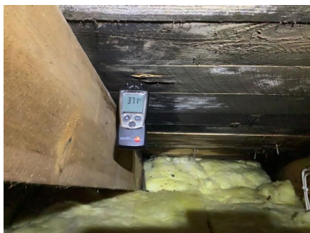
Taktro er våt over badet, og det er muggdannelser i taktro i dette området.
