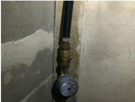
Tettemuffe mangler i enden av varerør.
