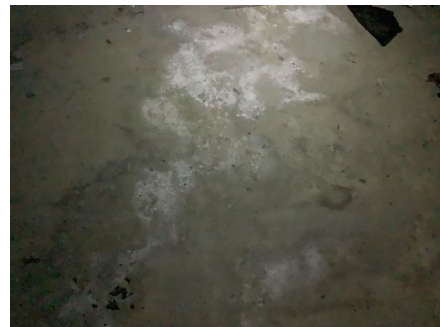
Eksempel på saltutslag på betonggulv.
