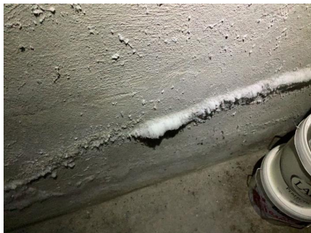
Saltutslag på grunnmur.
