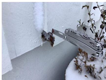
Eksempel på råteskadet bordkledning.
