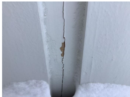
Eksempel på sprukket bordkledning.
