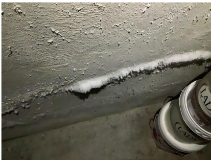
Eksempel på saltutslag på grunnmur.
