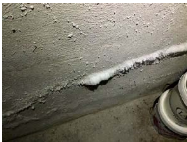
Saltutslag på grunnmur.
