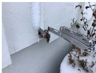
Eksempel på råteskadet bordkledning.
