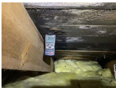
Taktro er våt over badet, og det er muggdannelser i taktro i dette området.
