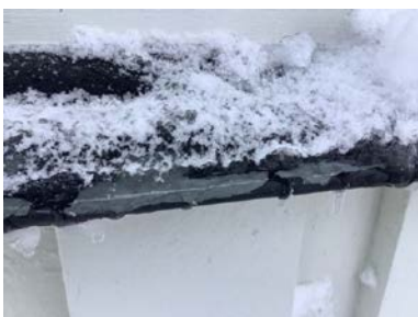
Eksempel på løsnet behandling på vannbrettbeslag.
