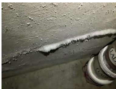
Eksempel på saltutslag på grunnmur.
