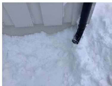
Eksempel på mangelfull bortledning av takvann.
