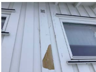
Eksempel på løsnet maling.
