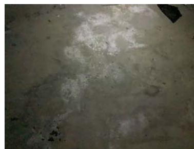
Eksempel på saltutslag på betonggulv.
