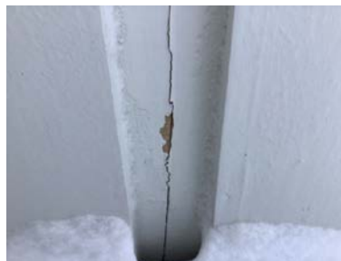
Eksempel på sprukket bordkledning.
