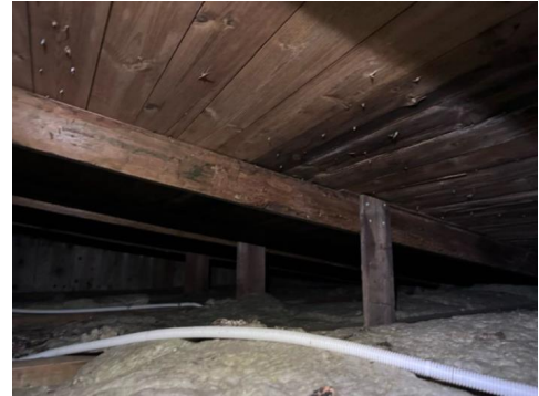
Viser misfarging på loft.
