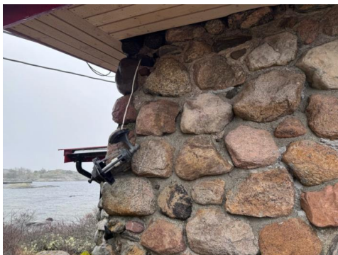
Løs lampe på boligens yttervegg.
