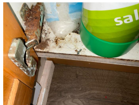
Viser underskap med svelleskade.
