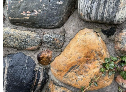
Viser sprekke i mur.
