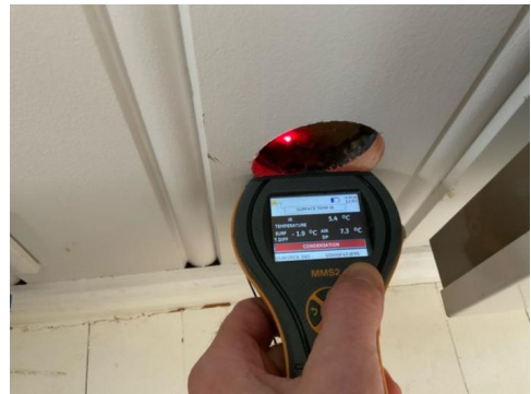
Viser høy kondens i yttervegg.
