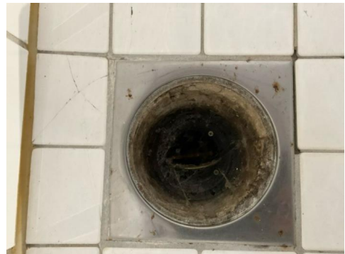
Viser sluk og sprukker flis.
