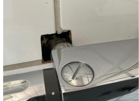
Viser mangelfull membran til rørgjennomføring.
