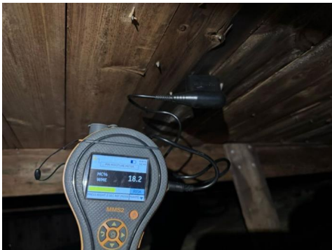
Viser høy fukt i undertak, 18,2%
