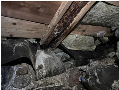
Viser fuktutsattmompde med fukt, muggsopp og råte.
