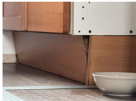
Viser løs sokkel og svelleskade.
