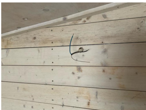
Usikrede ledninger på bod.
