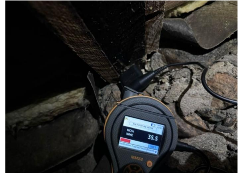
Viser høy fukt i bjelkelag inn mot mur.
