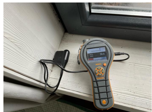
Viser høy fukt i karm.
