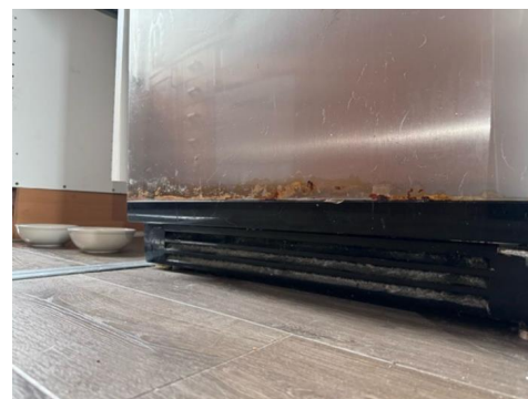
Misfarging på nedre del av kjøleskap.
