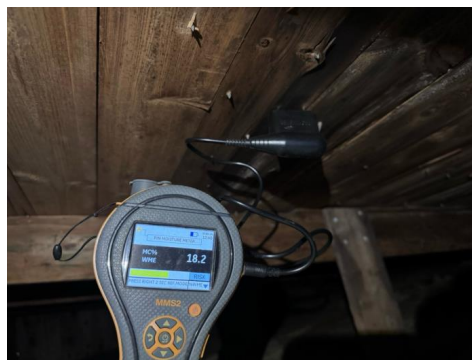
Viser fuktnivå på 18,2% på undertak.
