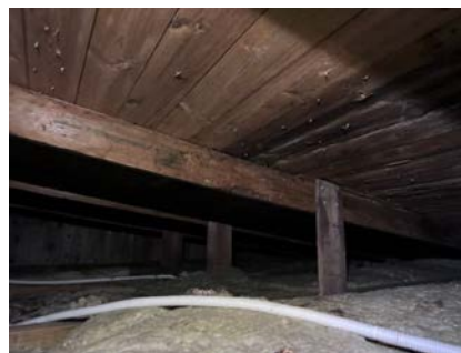
Viser misfarging på loft.
