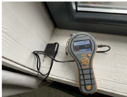
Viser høy fukt i karm.
