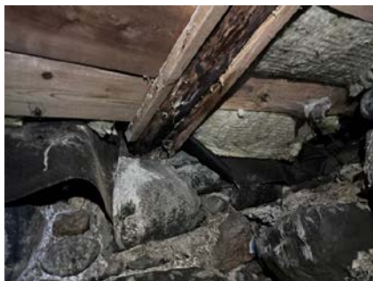
Viser fuktutsattmomrpe med fukt, muggsopp og råte.
