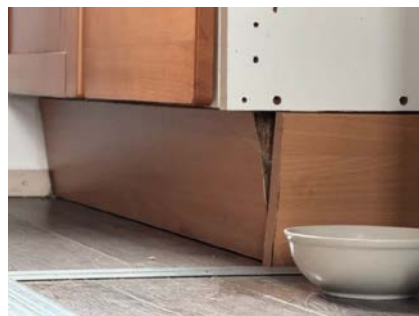
Viser løs sokkel og svelleskade.
