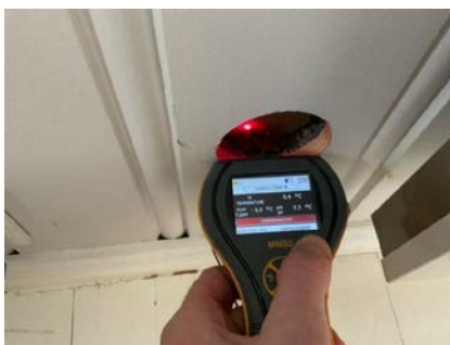
Viser høy kondens i yttervegg.
