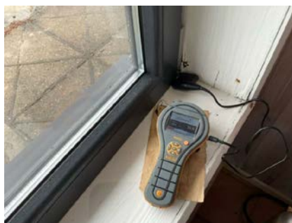
Viser 34,9% i vinduskarm
