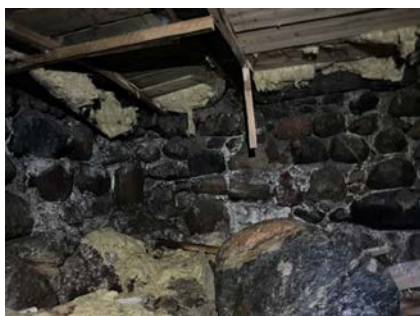
Viser område av stubbloft som har rast ned.
