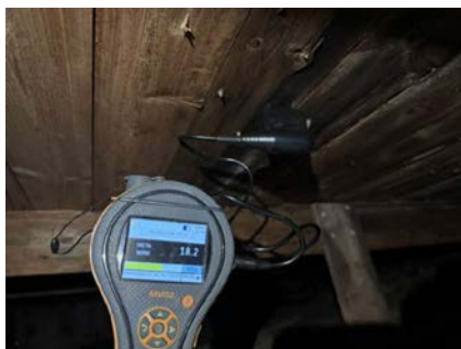
Viser høy fukt i undertak, 18,2%
