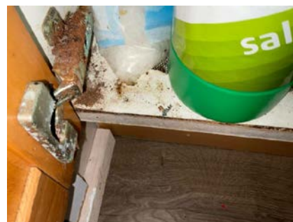
Viser underskap med svelleskade.
