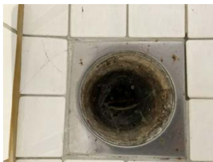
Viser sluk og sprukker flis.
