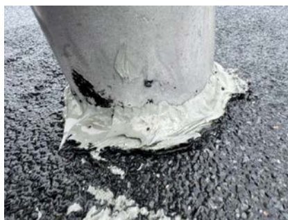
Det er kun fuget rundt rørgjennomføring, det anbefales en sveiset fuktsikring.
