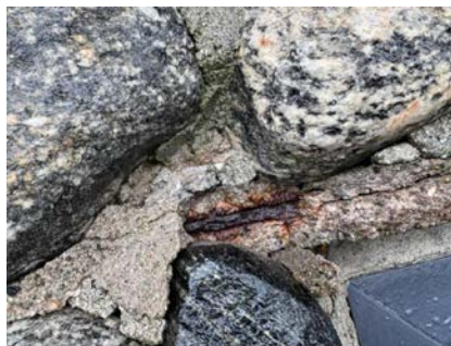
Viser synlig jern med rustdannelse.
