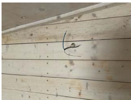
Usikrede ledninger på bod.
