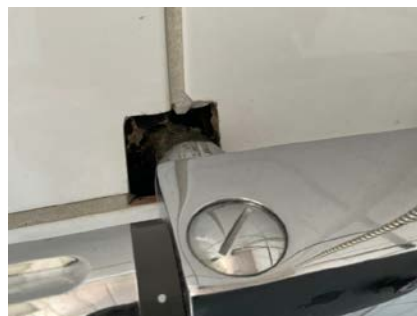
Viser mangelfull membran til rørgjennomføring.
