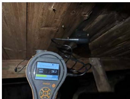
Viser fuktnivå på 18,2% på undertak.
