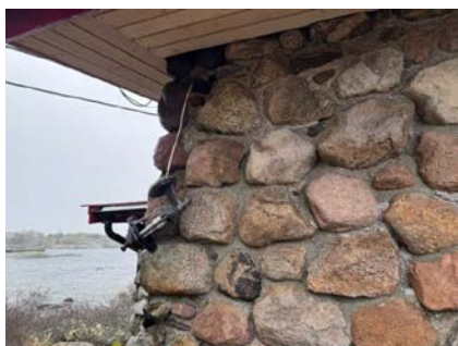
Løs lampe på boligens yttervegg.
