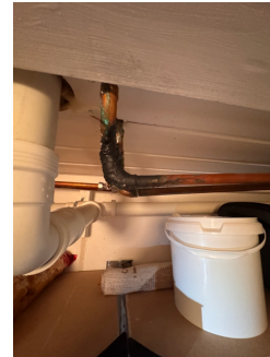
Det er registret lekkasje fra vannrør i kjellerbod.
