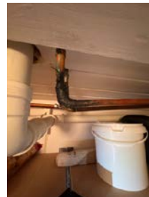
Det er registrert lekkasje fra vannrør i kjellerbod.
