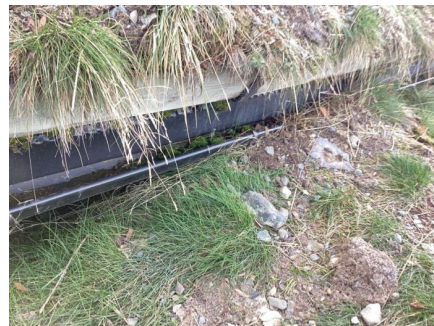
Takrenner bør rengjøres.
