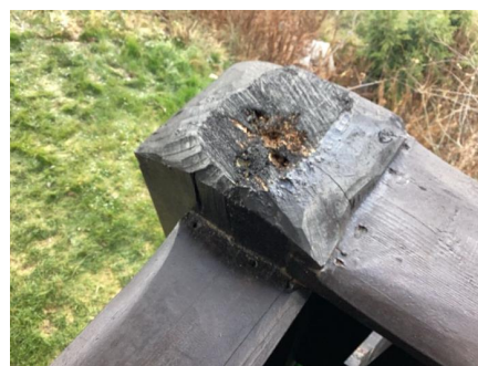
Noe påbegynnende råte, tettet med byggskum, ikke anbefalt løsning.
