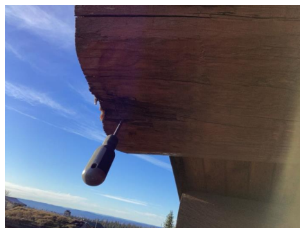
Råteskader i takåser registrert ved veranda.
