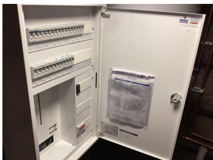
Sikringsskap på teknisk rom.
