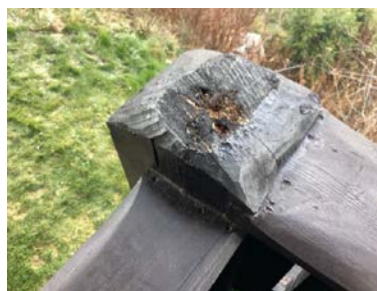
Noe påbegynnende råte, tettet med byggsaum, ikke anbefalt løsning.
