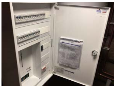
Sikringsskap på teknisk rom.
