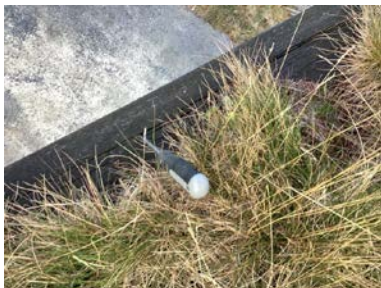
Toppbord bærer preg av slitasje.
