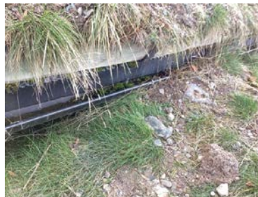
Takrenner bør rengjøres.
