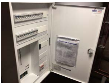
Sikringsskap på teknisk rom.
