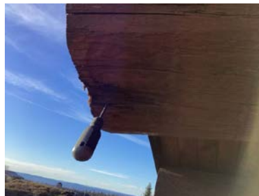
Råteskader i takåser registrert ved veranda.
