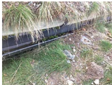
Takrenner bør rengjøres.
