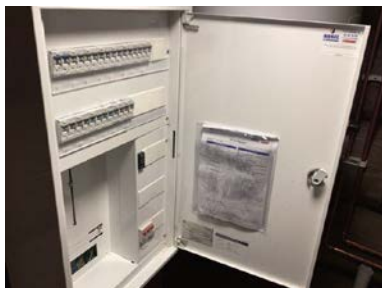
Sikringsskap på teknisk rom.
