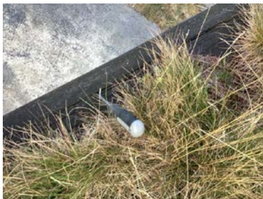
Toppbord bærer preg av slitasje.
