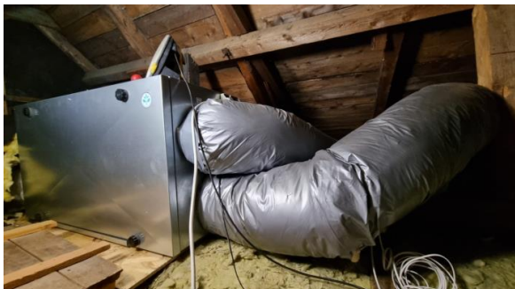
Ventilasjonsanlegg på kaldloftet.
