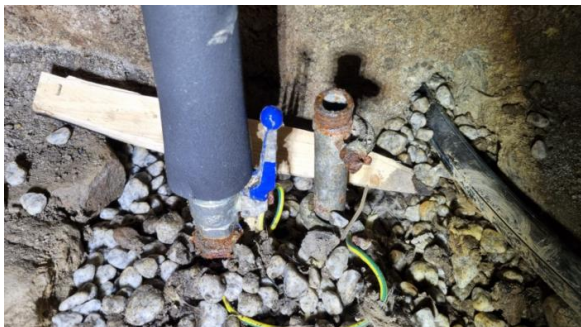
Kontroll av innvendig hovedstoppekran.
