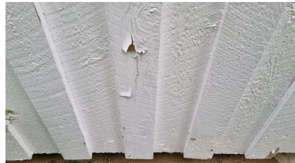
Malingsavflassing i enkelte kledningsbord.
