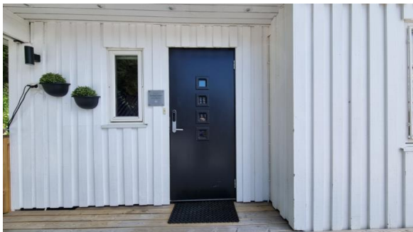
Hovedinngangsdør. Noe malingsavskalling i døren. Liten utetthet mellom dørblad og karm (nedre hjørne).
