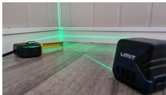
Kontroll av planavvik/ skjevheter i gulv.
