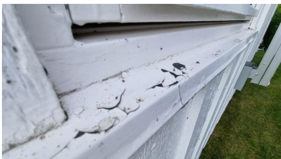
Malingsavflassing i utvendig beslag.
