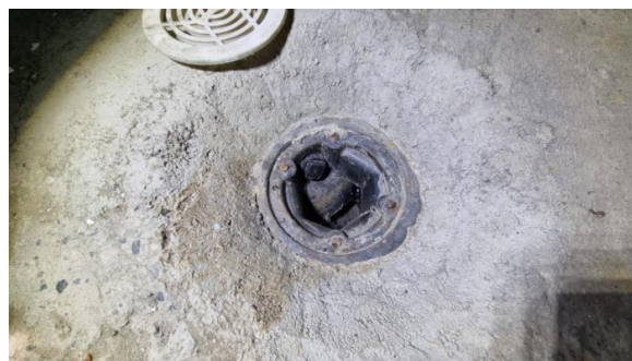
Plastsluk i kjeller.
