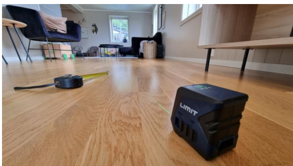
Kontroll av planavvik/ skjevheter i gulv.
