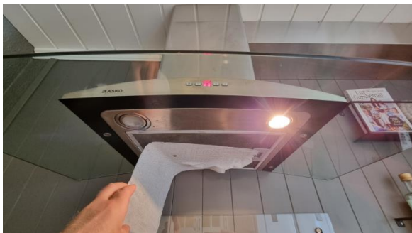
Funksjonstesting av det mekaniske avtrekket over koketoppen.
