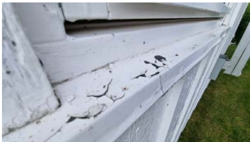
Malingsavflassing i utvendig beslag.
