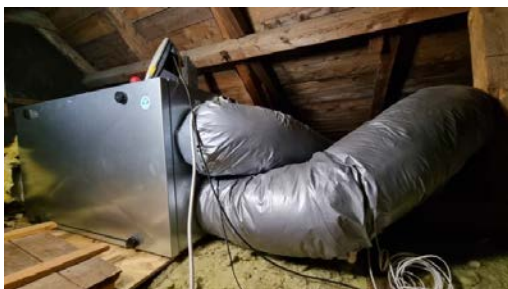
Ventilasjonsanlegg på kaldloftet.
