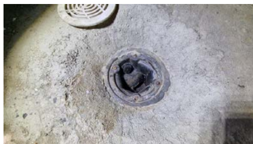
Plastsluk i kjeller.
