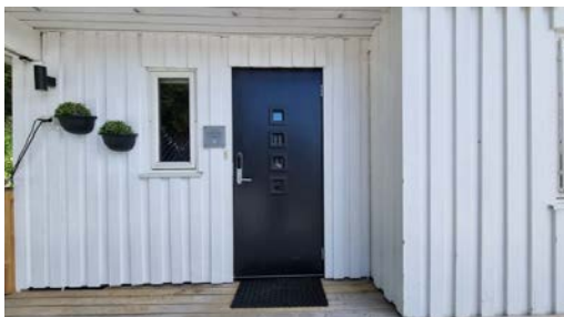
Hovedinngangsdør. Noe malingsavskalling i døren. Liten utetthet mellom dørblad og karm (nedre hjørne).
