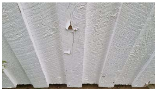
Malingsavflassing i enkelte kledningsbord.
