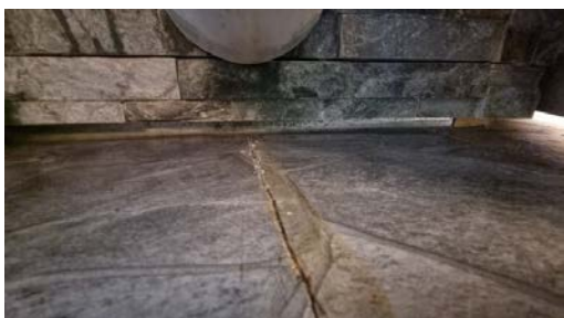
Sprekk i belegget under toalettet.
