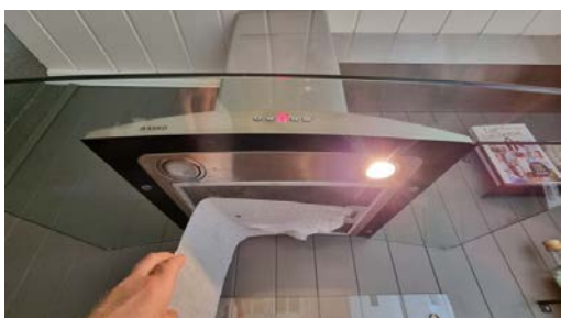
Funksjonstesting av det mekaniske avtrekket over koketoppen.
