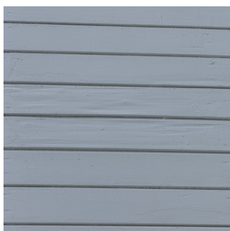
Kledningen buler innover i overflaten, vegg nord.
