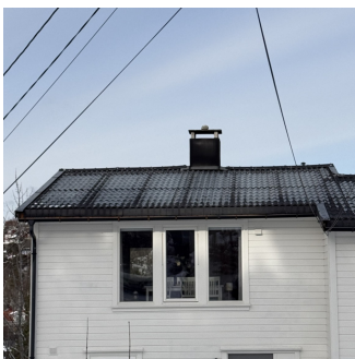
Ingen snøfangere eller stigetrinn
