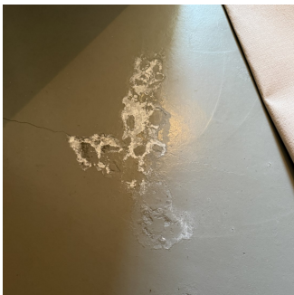
Saltutslag og fukt i gulv i trapperom
