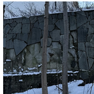
Manglede skifer og vertikal sprekk mot nord
