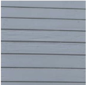
Kledningen buler innover i overflaten, vegg nord.
