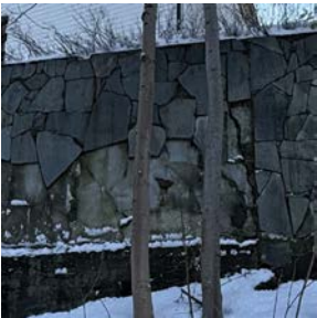
Manglede skifer og vertikal sprekk mot nord
