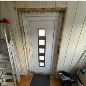
Innvendig belisting ikke utført
