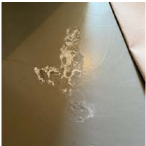
Saltutslag og fukt i gulv i trapperom
