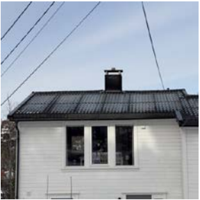
Ingen snøfangere eller stigetrinn
