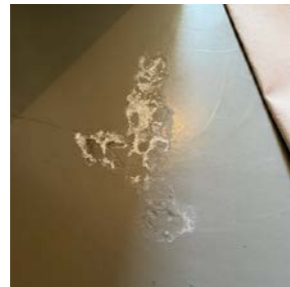
Saltutslag og fukt i gulv i trapperom
