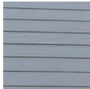
Kledningen buler innover i overflaten, vegg nord.
