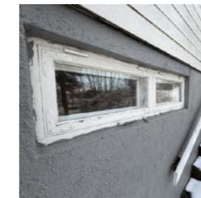
Koblet vindu, har behov for vedlikehold og mangler beslag.
