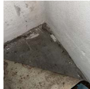
Fukt og saltutslag i vegg, og fukt i gulv i bod mot sørøst. Mugg-/bakterievekst på undersiden av belegget.
