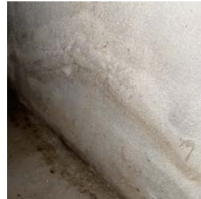
Fukt og saltutslag i vegg, og fukt i gulv i bod mot sørvest.
