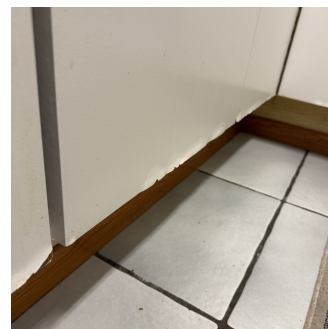
Fuktskade i bunnen av fronter
