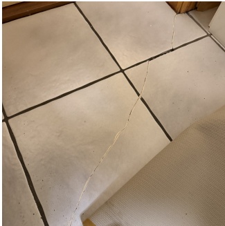
Riss/sprekk i flis og fug i gang
