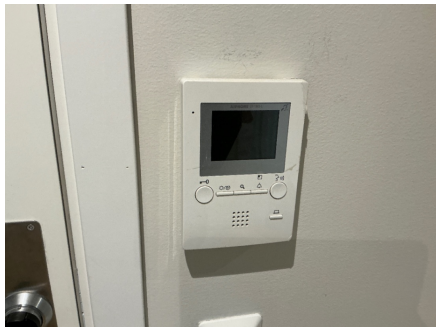
Dørcalling med monitor er plassert i gang.
