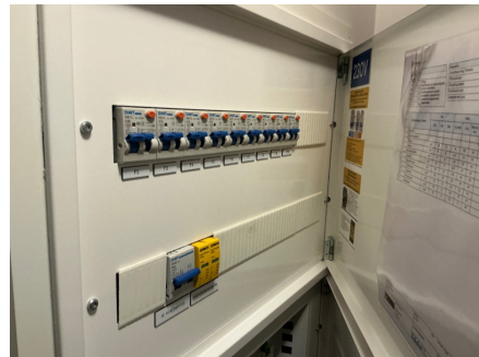
Automatsikringer i sikringsskap plassert i bod.
