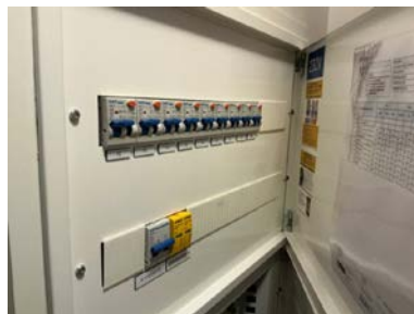
Automatsikringer i sikringsskap plassert i bod.
