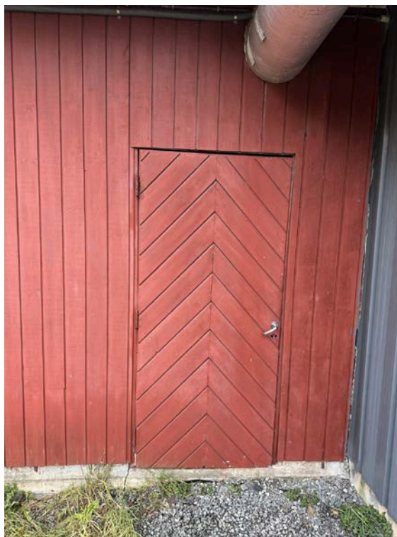
Her viser setningsskaden ved dør.
