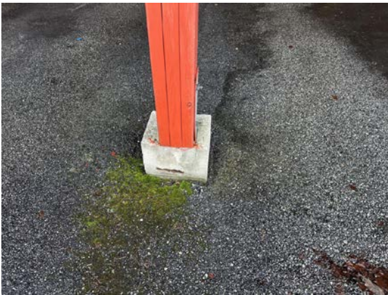
Mangelfull utførelse der treverk går ned til betong. Her mangler det papp mellom treverk og betong. Dette går igjen på alle søyler.
