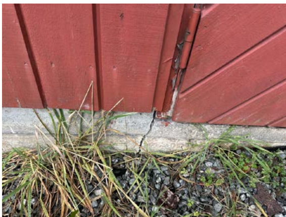
Setningsskade i fundament.
