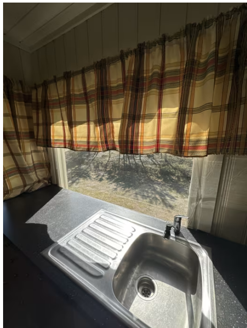
Vindu kan ikke åpnes pga kjøkkeninnredning.
