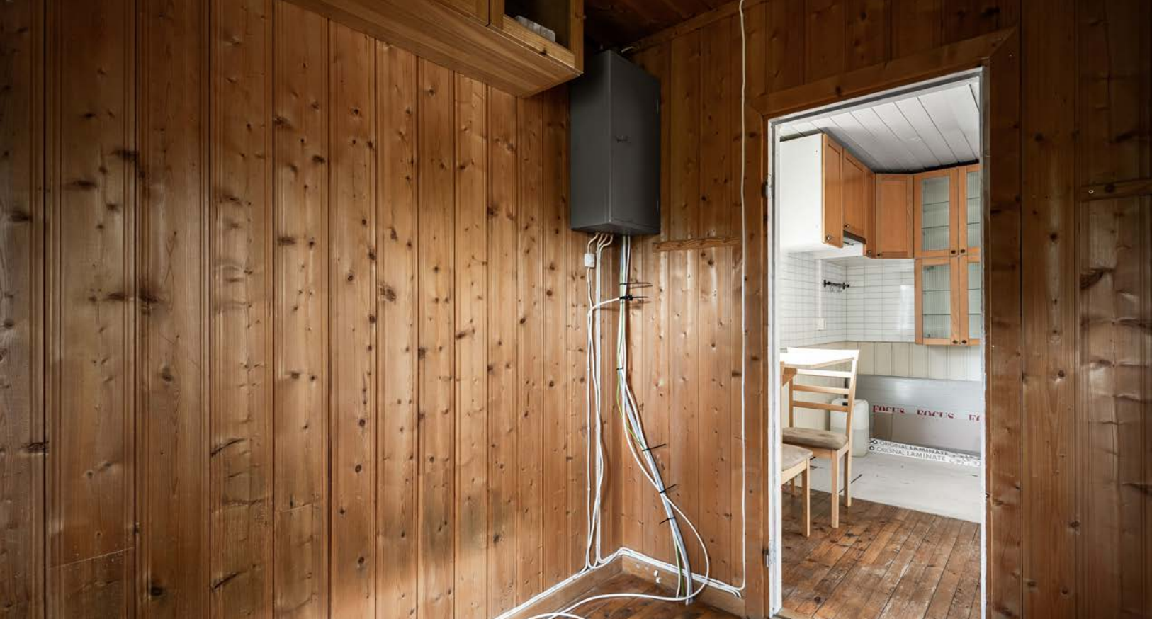
Sikringsskap med skrusikringer, en jordfeilautomat og måler. Det er utført enkelte oppgraderinger. Det gjenstår arbeid med å ferdigstille anlegget.
