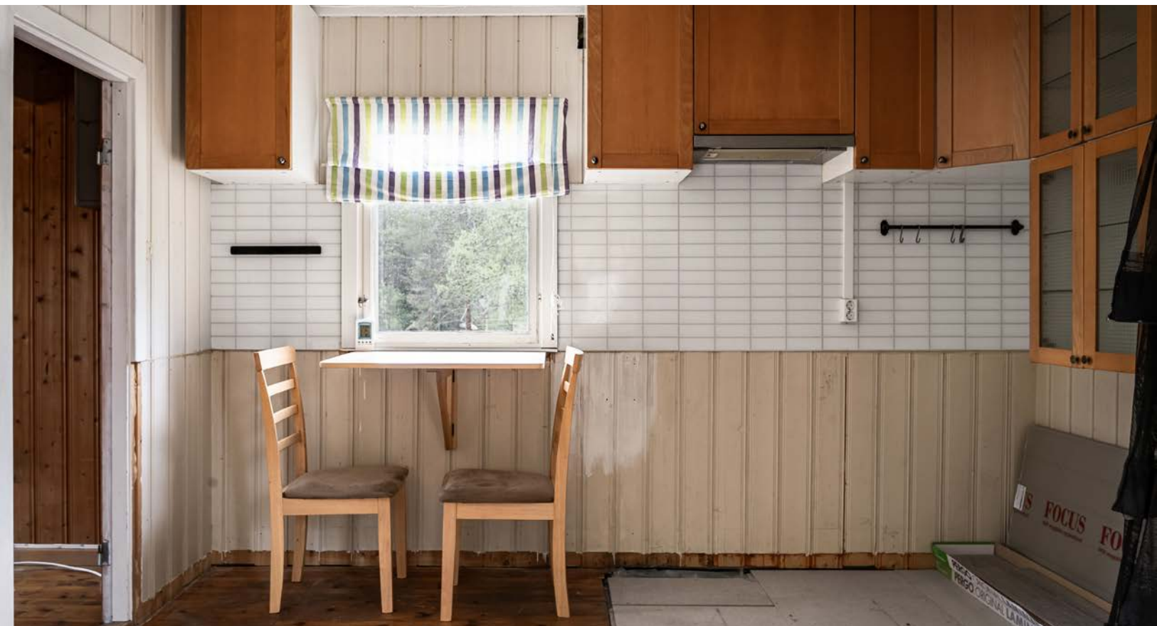
Denne etasjen bærer preg av manglende vedlikehold og har behov for oppgraderinger.
