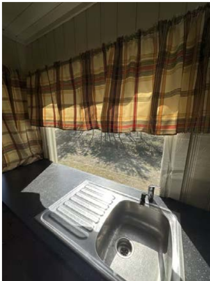
Vindu kan ikke åpnes pga kjøkkeninnredning.
