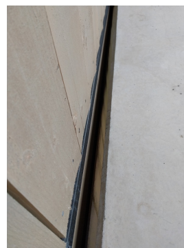
Manglende beslag mellom yttervegg og åpen balkong.
