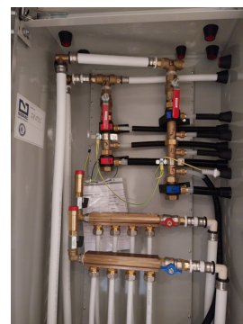
Fordelerskap med flislågt pop-up dør plassert på bad
