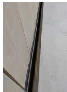
Manglende beslag mellom yttervegg og åpen balkong.
