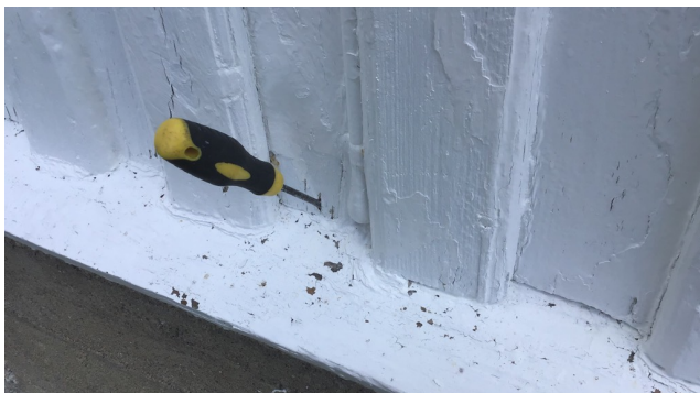
Punktvis råteskader i nedkant kledning
