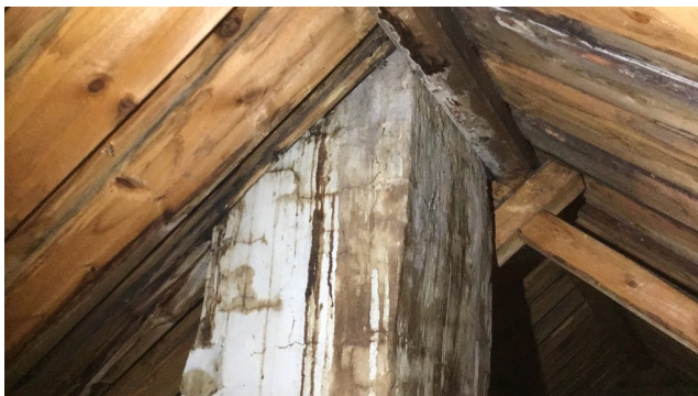
Fukt merker rundt pipe
