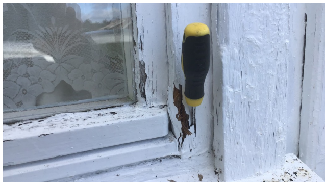
Skader i vinduskarm
