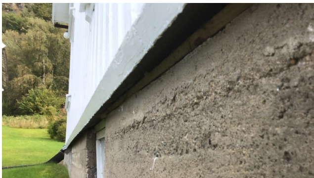
Begrenset lufting bak kledning
