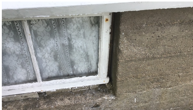
Råte skader i vindu og utettheter
