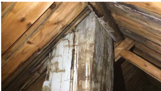
Fukt merker rundt pipe
