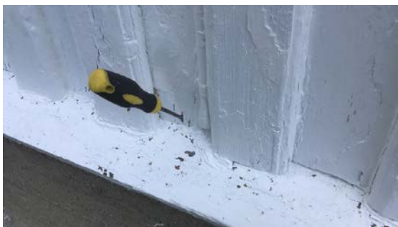
Punktvis råteskader i nedkant kledning
