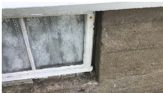
Råte skader i vindu og utettheter
