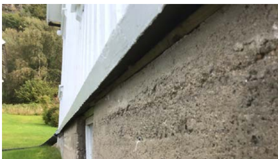
Begrenset lufting bak kledning
