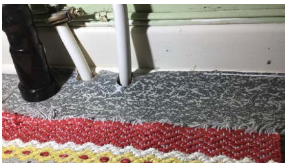
uttettheter rundt rør
