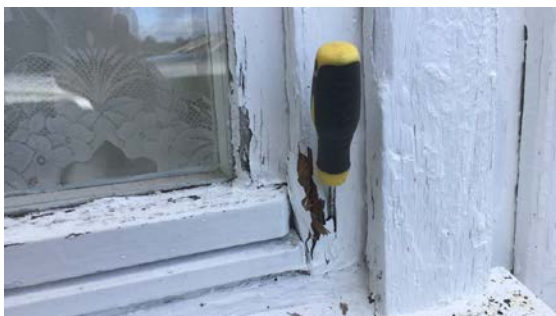
Skader i vinduskarm
