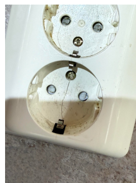
Bildet viser sprekk i stikkontakt på kjøkkenet.
