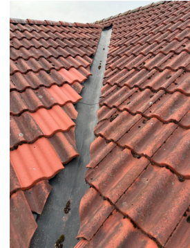
Bildet viser takstein som ikke er tilpasset kilrennen.
