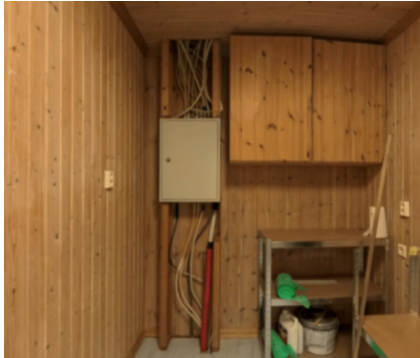
Bildet viser sikringsskap.
