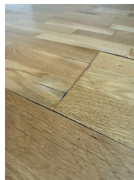
Bildet viser parkett med fuktskade på soverom.
