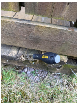
Bildet viser terrasse med stedvis råteskader i terrassebord.
