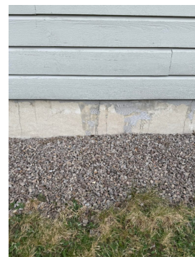
Bildet viser mindre riss og sår i grunnmurens overflate.
