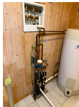
Bildet viser fordelerskap på vaskerom.
