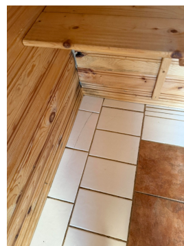
Bildet viser sprukne fliser i boden.
