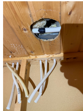
Bildet viser brutt dampsperre fra vaskerom.
