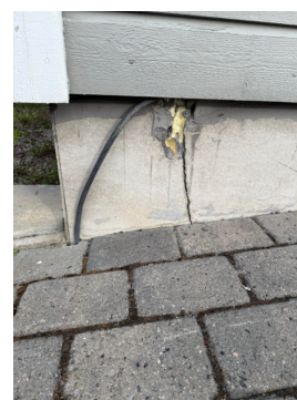
Bildet viser kabel som er ubeskyttet.
