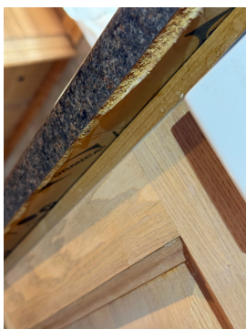
Bilde av svelling i underkant av benkeplaten.
