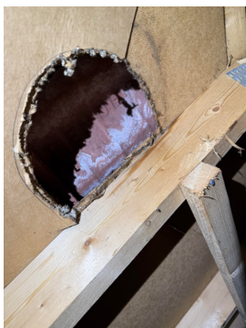
Bildet viser synlig åpning i undertaket.
