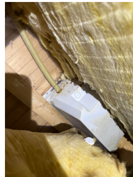
Bildet viser spottkasse med brutt dampsperre.
