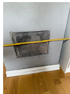
Bildet viser avstand til sotluke.
