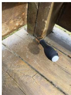
Bildet viser terrasse med stedvis råteskader i rekkverk.
