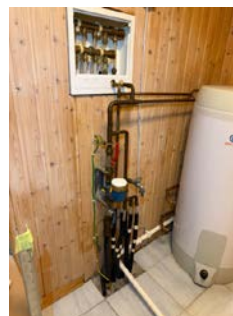
Bildet viser fordelerskap på vaskerom.
