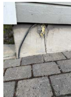
Bildet viser kabel som er ubeskyttet.
