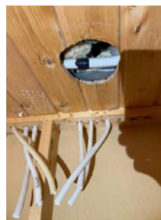
Bildet viser brutt dampsperre fra vaskerom.
