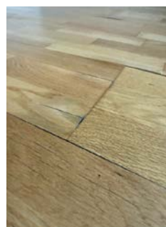
Bildet viser parkett med fuktskade på soverom.
