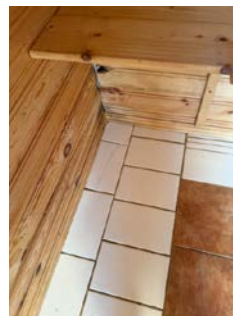
Bildet viser sprukne fliser i boden.
