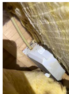
Bildet viser spottkasse med brutt dampsperre.
