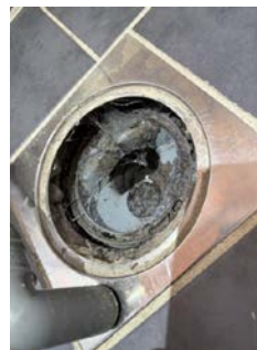
Bildet viser sluk ved vaskemaskin.
