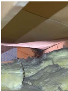
Bildet viser fuktskjolder i taksperre i nedkant av kilrennen.
