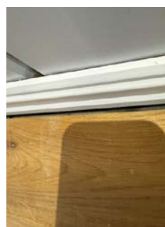
Bildet viser glippe i listverk i overgang mellom vegg og gulv.
