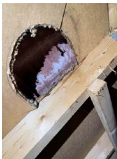
Bildet viser synlig åpning i undertaket.
