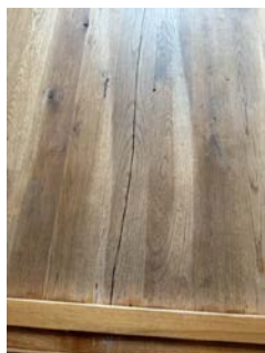
Bildet viser sprekke i gulvbord på soverom.
