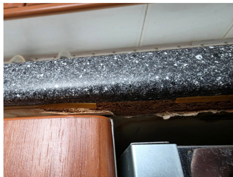
Fuktskade på benkeplate ved oppvaskmaskin
