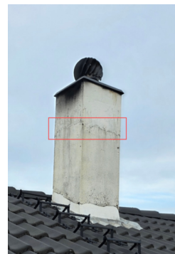
Pipe bør undersøkes ytterligere.
