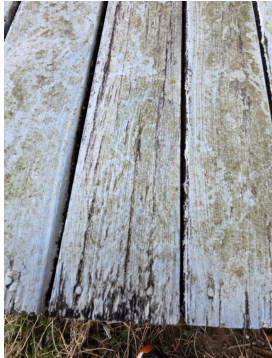
Sprekker og værslitt terrassedekke
