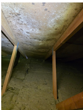
Fuktmerker og soppdannelse i undertak. Isolasjonen i undergurt er uten vindsperre/papp.
