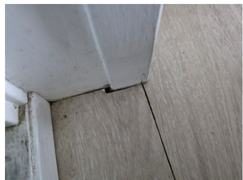
Noe ufagmessig utførelse på laminatgulv
