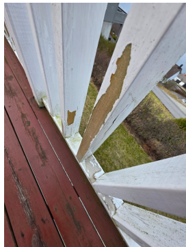
Rekkeverk har behov for vedlikehold
