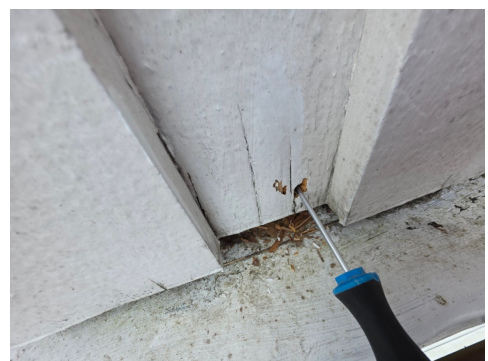
Stedvis råteskadet kledning
