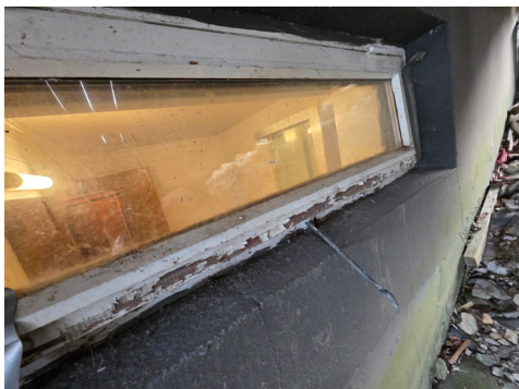
Vindu til bad i kjeller lar seg ikke betjene. Vindu må byttes ut.
