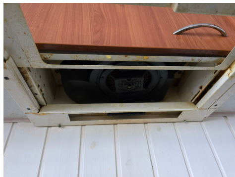
Det mangler fettfilter
