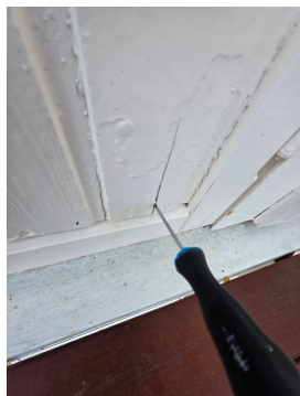
Sprekker, fukt og begynnende råde på paneler
