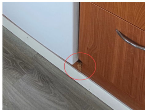
Skade på sokkel
