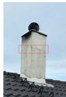
Pipe bør undersøkes ytterligere.
