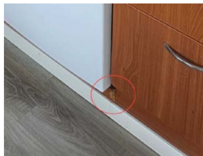
Skade på sokkel
