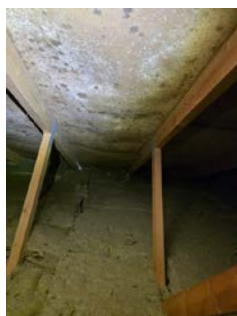
Fuktmerker og soppdannelse i undertak. Isolasjonen i undergurt er uten vindspærre/papp.
