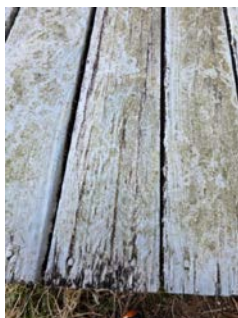
Sprekker og værslitt terrassedekke
