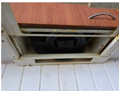
Det mangler fettfilter
