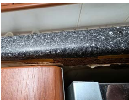
Fuktskade på benkeplate ved oppvaskmaskin
