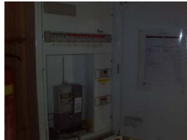
Sikringsskapet er plassert i gangen.
