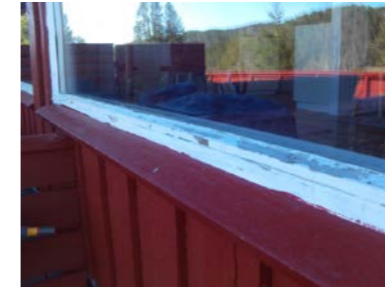
Noe utvendig vedlikehold må beregnes
