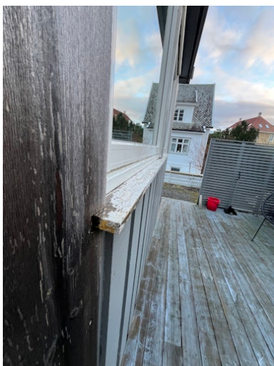
Vannbord med dårlig helling / avrenning.
