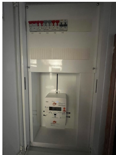
Sikringsskap i kjeller fra 2012
