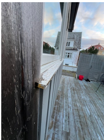
Vannbord med dårlig helling / avrenning.
