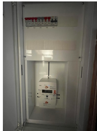
Sikringsskap i kjeller fra 2012
