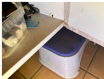
Noe fuktsvelling på skapinnredningen
