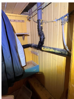
Dårlig festede rør, ufagmessig utførelse.
