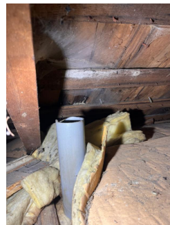
Fuktmerker i bordtro som følge av kloakk luftingen.
