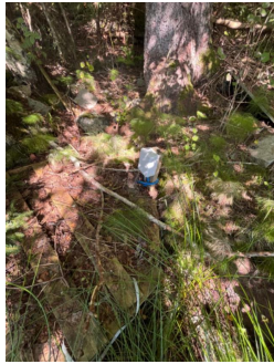
Brønn og koblingsboks for brønnpumpe.
