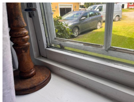
Vindu soverom 1 etasje, kan ikke lukkes skikkelig.
