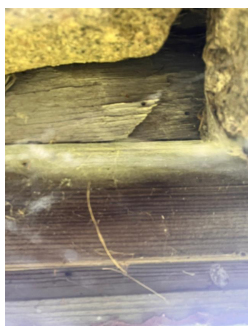
Ingen lufting i nedkant på kledningen, gjelder vegger som ikke har ny kledning.
