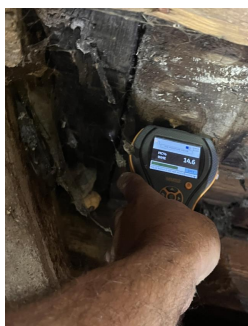
Fuktkontroll med pigger i trevirke nedenfor pipe.
