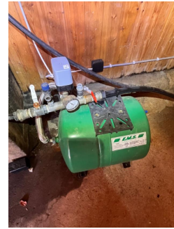
Innvendig stoppekran og trykktank.
