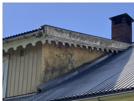
Veggekledning på takoppløft er slitt.
