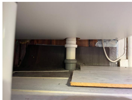
Dårlig festet kabel.
