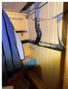
Dårlig festede rør, ufagmessig utførelse.
