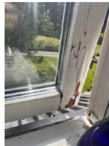
Vindu kjøkken 2 etasje, slitt og skader av kondensvann.
