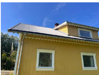
Beslag er ikke fagmessig montert
