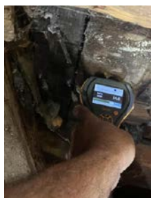
Fuktkontroll med pigger i trevirke nedenfor pipe.
