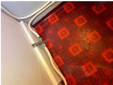
Dårlig festede rør, ufagmessig utførelse.
