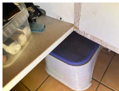
Noe fuktsvelling på skapinnredningen
