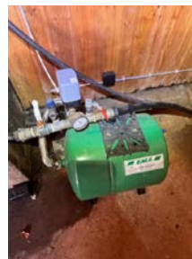
Innvendig stoppekran og trykktank.
