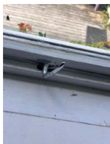
Vindu kjøkken 1 etasje, nordvest vegg, kan ikke lukkes skikkelig.
