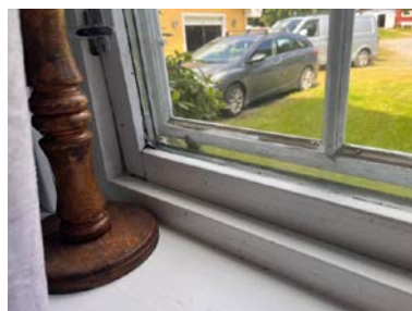
Vindu soverom 1 etasje, kan ikke lukkes skikkelig.
