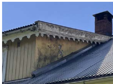
Veggkledning på takoppløft er slitt.
