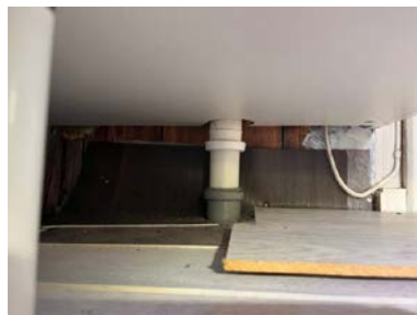
Dårlig festet kabel.
