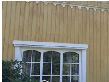
Gjenkledd vindu, panel skjøtet inn, begynnende råte i skjøt.
