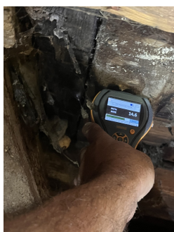
Fuktkontroll med pigger i trevirke nedenfor pipe.
