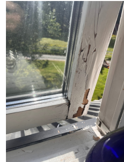
Vindu kjøkken 2 etasje, slitt og skader av kondensvann.
