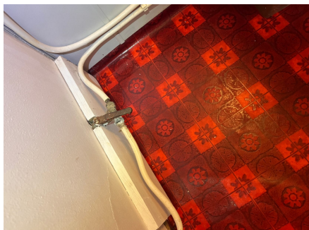
Dårlig festede rør, ufagmessig utførelse.
