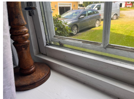
Vindu soverom 1 etasje, kan ikke lukkes skikkelig.
