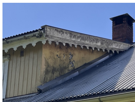
Veggekledning på takoppløft er slitt.
