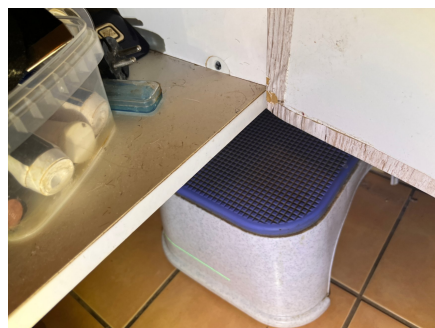
Noe fuktsvelling på skapinnredningen
