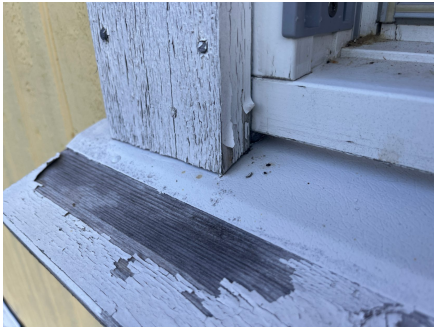
Vindu 2 etasje sørvest vegg, omramming helt ned på vannbrett.
