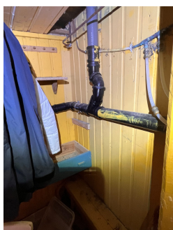
Dårlig festede rør, ufagmessig utførelse.
