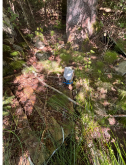
Brønn og koblingsboks for brønnpumpe.
