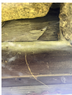
Ingen lufting i nedkant på kledningen, gjelder vegger som ikke har ny kledning.
