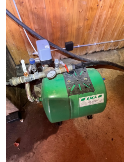
Innvendig stoppekran og trykktank.
