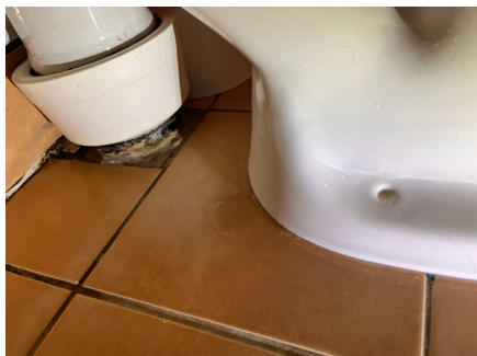
Kondensvann fra toalett.
