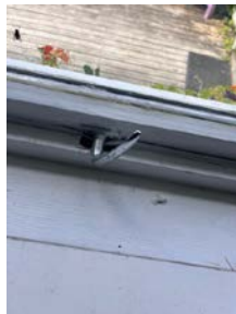
Vindu kjøkken 1 etasje, nordvest vegg, kan ikke lukkes skikkelig.
