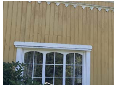
Gjenkledt vindu, panel skjøtet inn, begynnende råte i skjøt.
