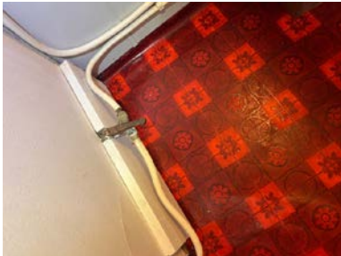
Dårlig festede rør, ufagmessig utførelse.
