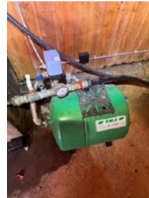
Innvendig stoppekran og trykktank.
