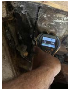
Fuktkontroll med pigger i trevirke nedenfor pipe.
