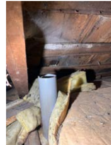
Fuktmerker i bordtro som følge av kloakk luftingen.
