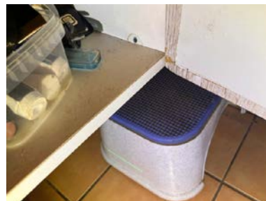
Noe fuktsvelling på skapinnredningen
