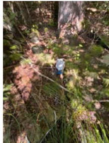
Brønn og koblingsboks for brønnpumpe.
