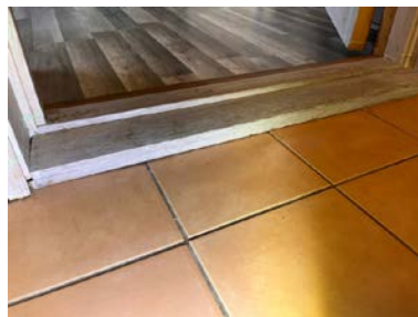
Dør til soverom, usikkert om det er noen oppkant på membranen.
