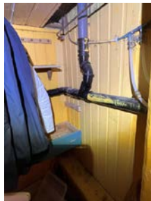
Dårlig festede rør, ufagmessig utførelse.
