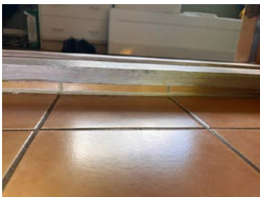
Dør til garderobe, ikke dokumentert at det er laget oppkant på membran.
