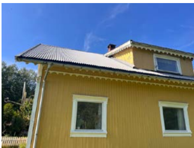
Beslag er ikke fagmessig montert
