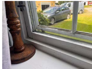
Vindu soverom 1 etasje, kan ikke lukkes skikkelig.
