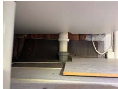
Dårlig festet kabel.
