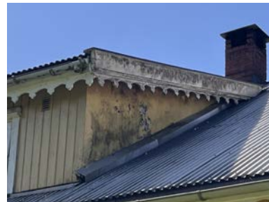
Veggkledning på takoppløft er slitt.
