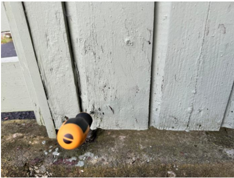
Råte i kledning i nedre del av levegg.
