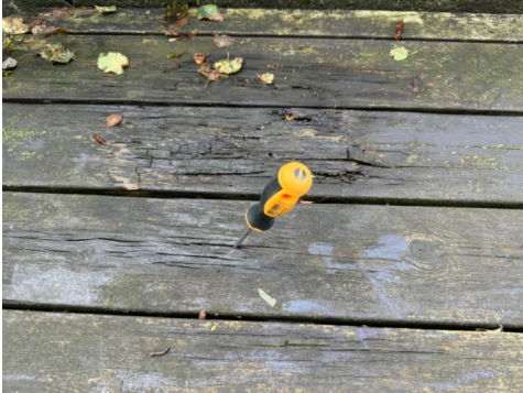
Råteskader i terrassebord.
