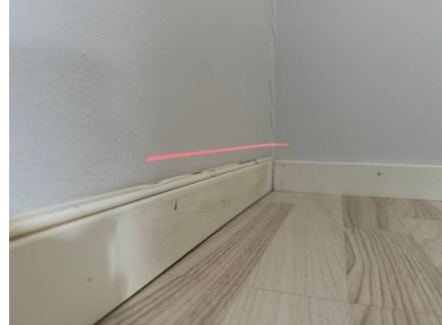
Bilder viser skjevheter i gulv i stue/kjøkken.
