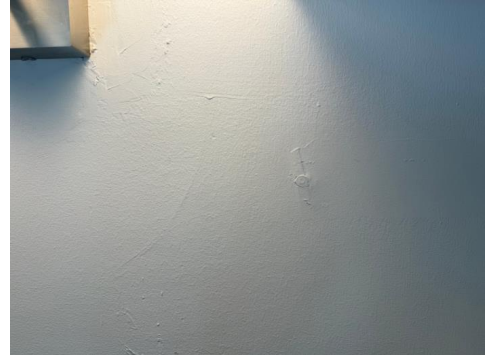
Det er noe ujevn veggoverflate på kjøkkenet.
