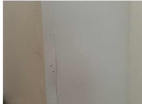
Delvis løsnet gipshjørne på soverom.
