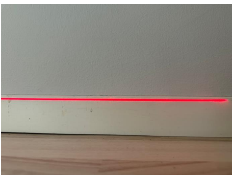
Bilder viser skjevheter i gulv i stue/kjøkken.
