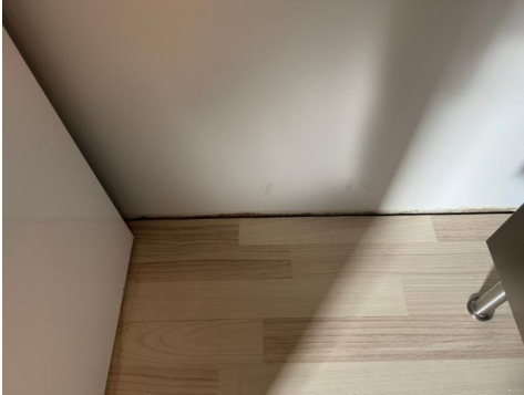
Manglende gulvlist på kjøkken.
