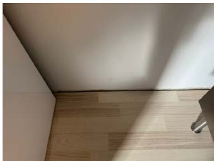
Manglende gulvlist på kjøkken.
