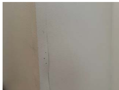
Delvis løsnet gipshjørne på soverom.
