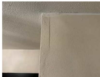
Delvis løsnet gipshjørne i entre/gang.
