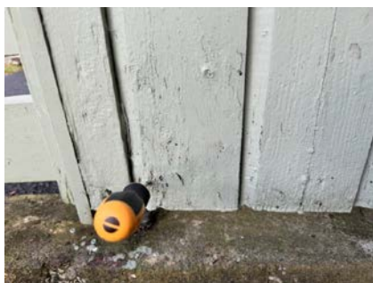
Råte i kledning i nedre del av levegg.
