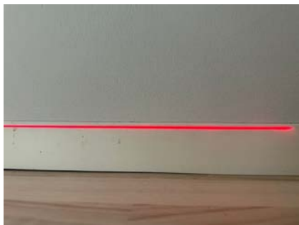
Bilder viser skjevheter i gulv i stue/kjøkken.
