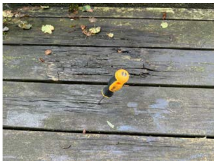
Råteskader i terrassebord.
