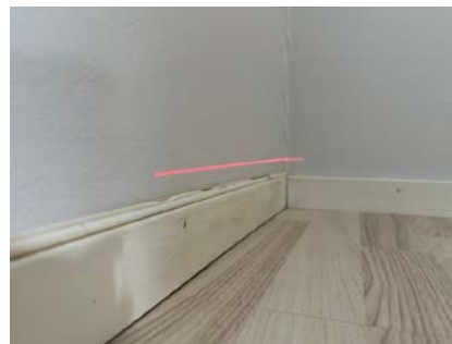
Bilder viser skjevheter i gulv i stue/kjøkken.
