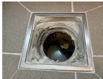
Eldre plastsluk i dusjsone.
