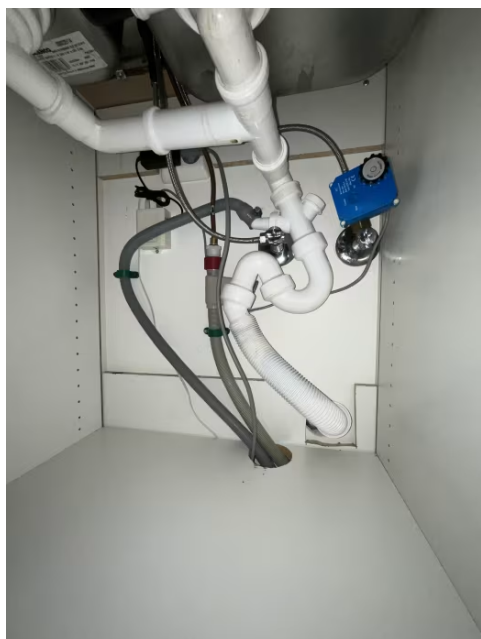
Viser vann og avløpsinstallasjoner under kum.
