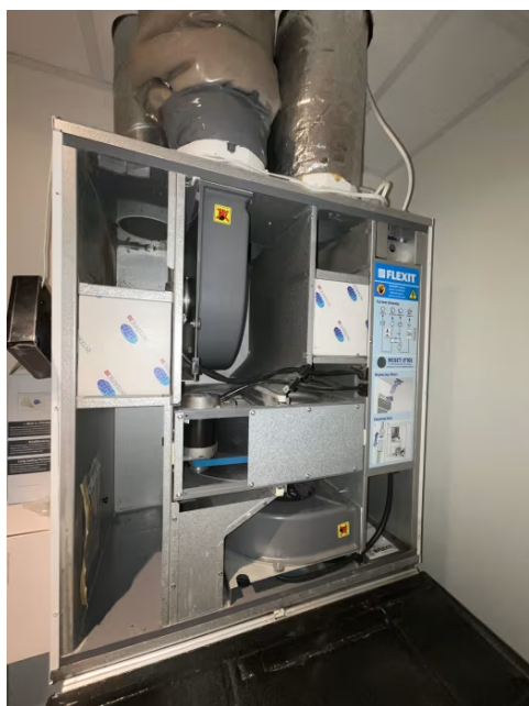
Balansert ventilasjons med aggregat plassert i teknisk rom.
