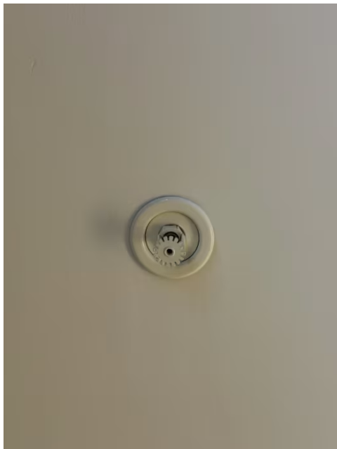
Viser sprinkel i tak.
