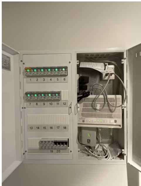
Viser sikringskap plassert på teknisk rom.
