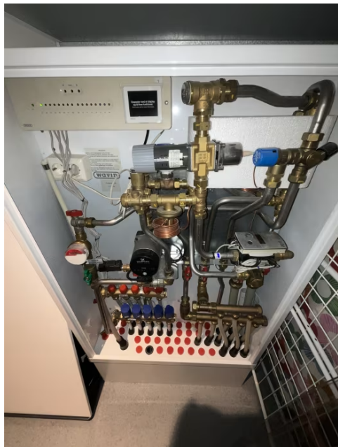
Viser fordelerskap for varme og forbruksvann etablert på teknisk rom.
