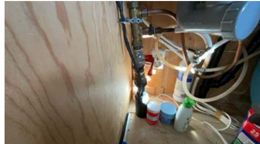
Del av rør til vann.
