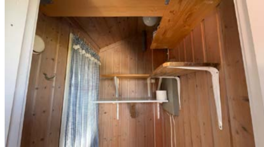
Del av toalettrom.
