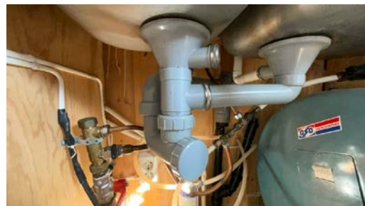
Del av rør til avløp.
