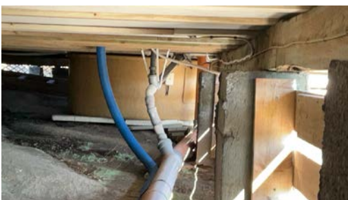
Del av rør til avløp.
