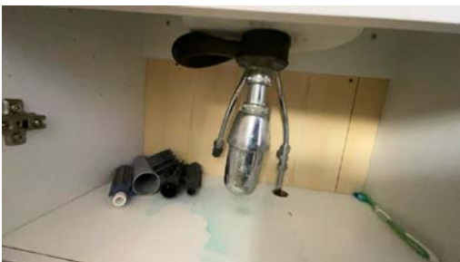
Del av rør til avløp.
