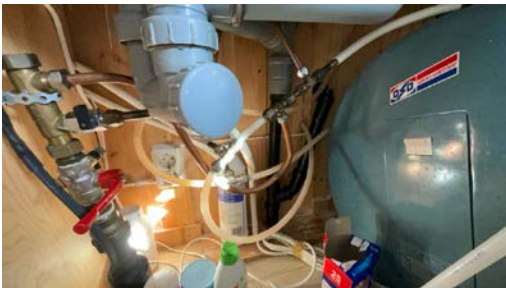
Stoppekran til vann. Del av rør til vann.
