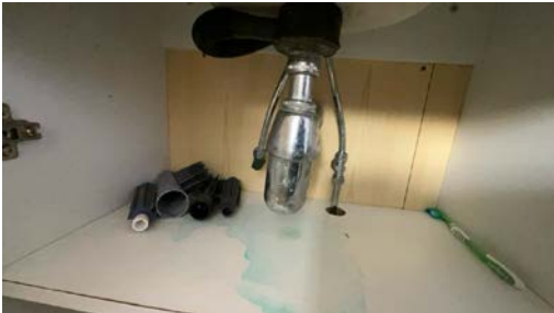
Del av rør til vann.
