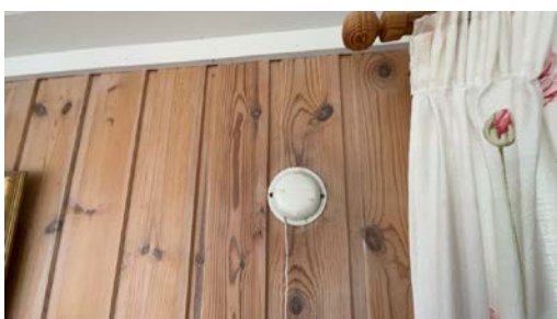
Eksempel på montert ventil i vegg.
