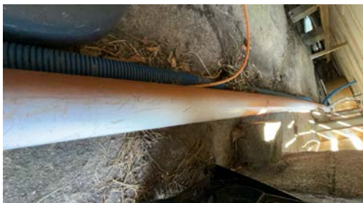
Eksempel på avløpsrør under hytte
